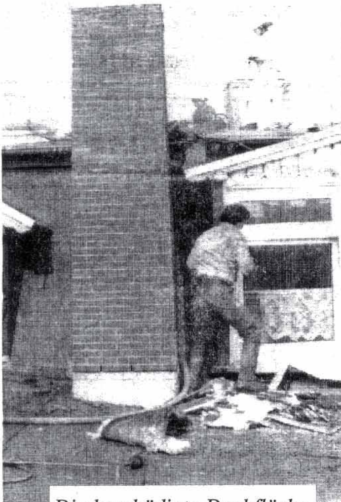
Die beschädigte Dachfläche
